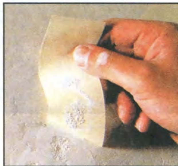
Проверка прочности штукатурки: резко сорвать приклеенную к стене малярную ленту. Если на ней остались частицы штукатурки, значит стену надо грунтовать.
