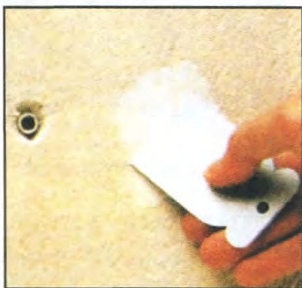
Эту неровную поверхность необходимо зашпатлевать. Кроме того, надо еще вытащить дюбель.
